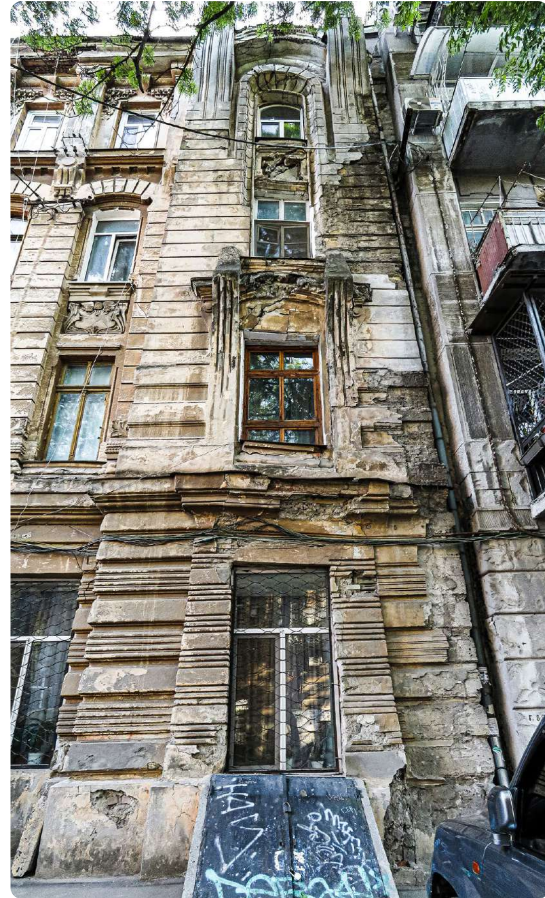
Дефекти системи водовідведення призвели до руйнації оздоблення фасаду
